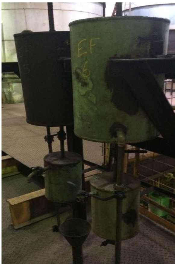
Figura 7 – Amostrador de condensado das colunas barométricas
