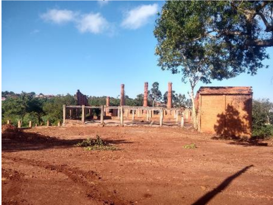
Figura 18. Vista da entrada no nível mais alto, à direita, a construção com as instalações elétricas.
