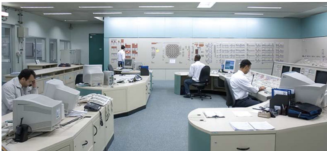
Figura 21 - Sala de controle - Central de operação. Fonte: Indústrias Nucleares do Brasil (2010 apud BANCO...2010.)
