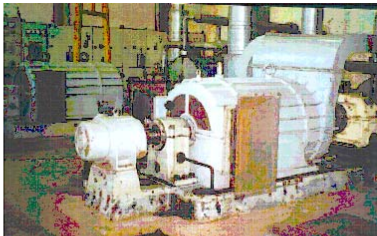
Figura 45: Geradores 1500kVA, 380V.
