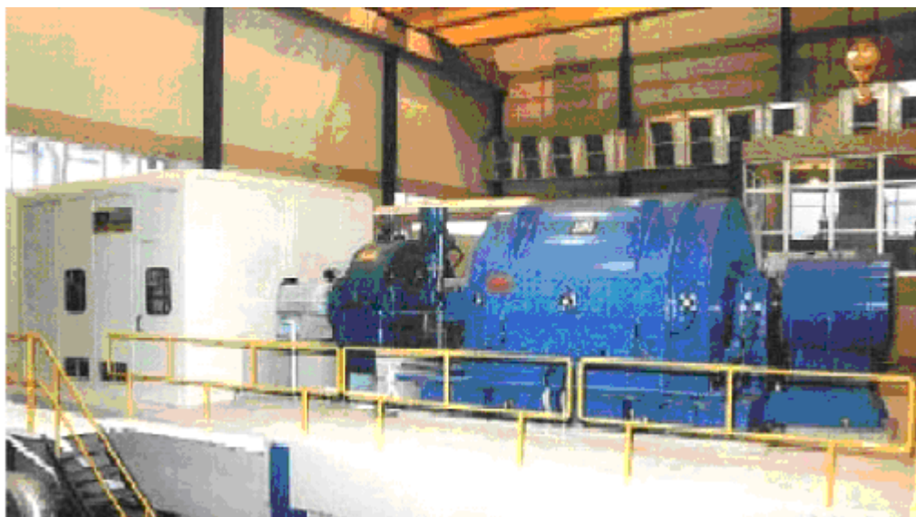
Figura 46: Geradores 31.250kVA, 13800V.
