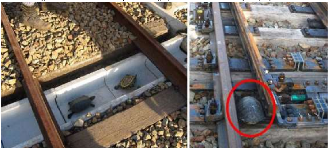
Figura 8 – Túneis exclusivo para tartarugas, Linha JR WEST Wakayama, Japão
