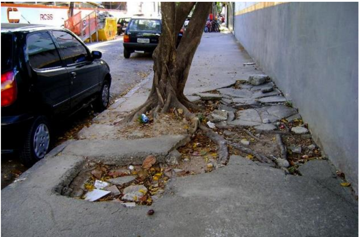
Figura 11 – Calçada com piso danificado pelas raízes da árvore
