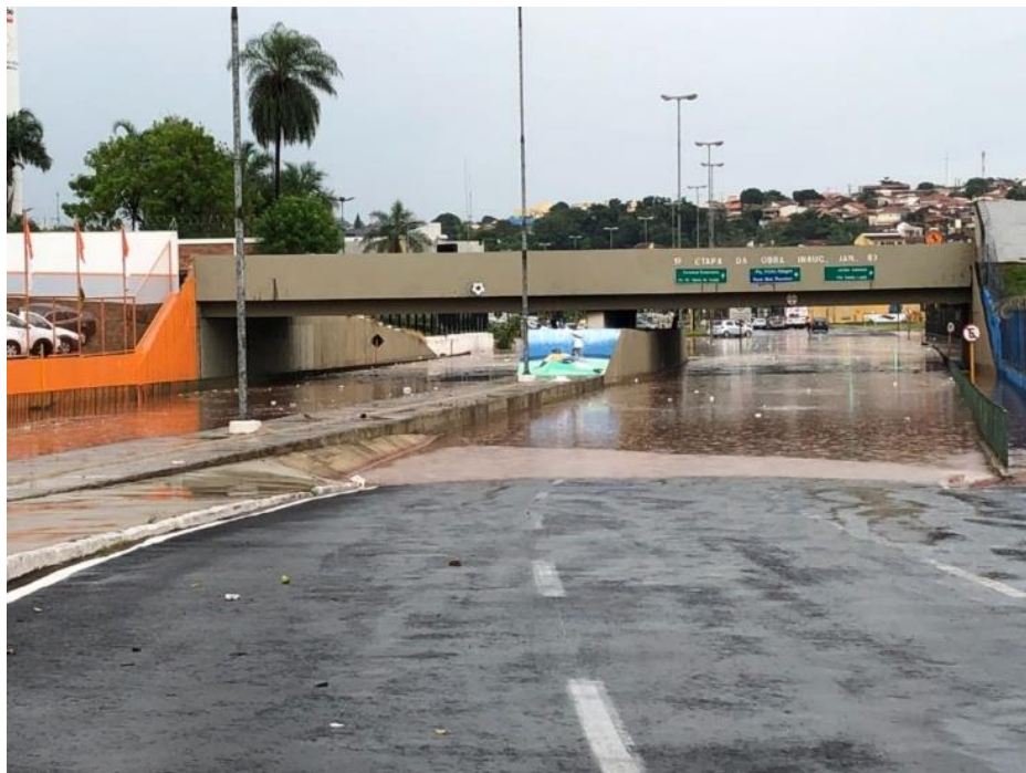
Figura 18 – Alagamento que interditou a Avenida Nações Unidas
