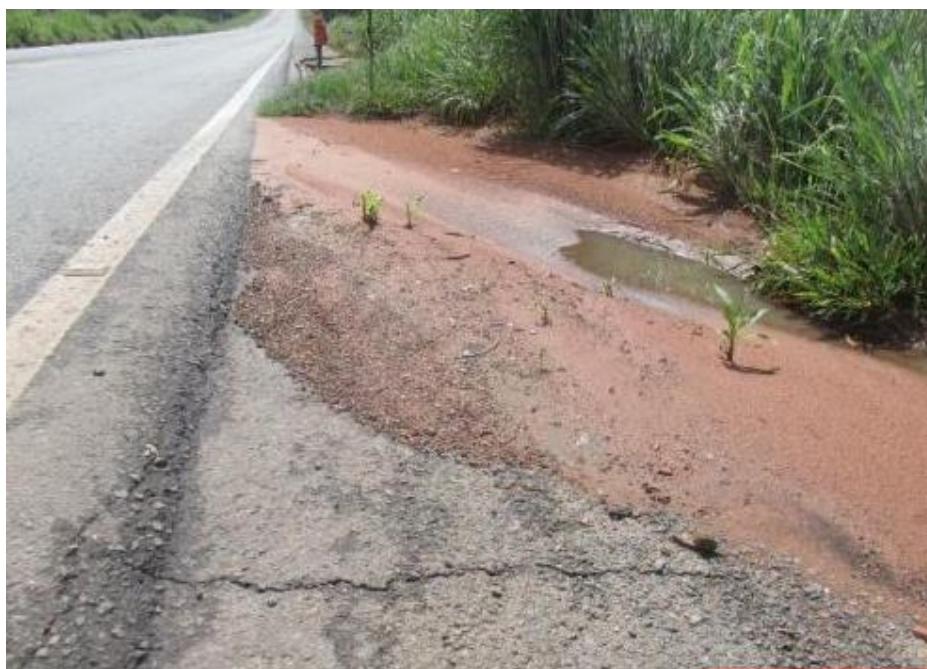
Figura 12 – Infiltração pelo acostamento
