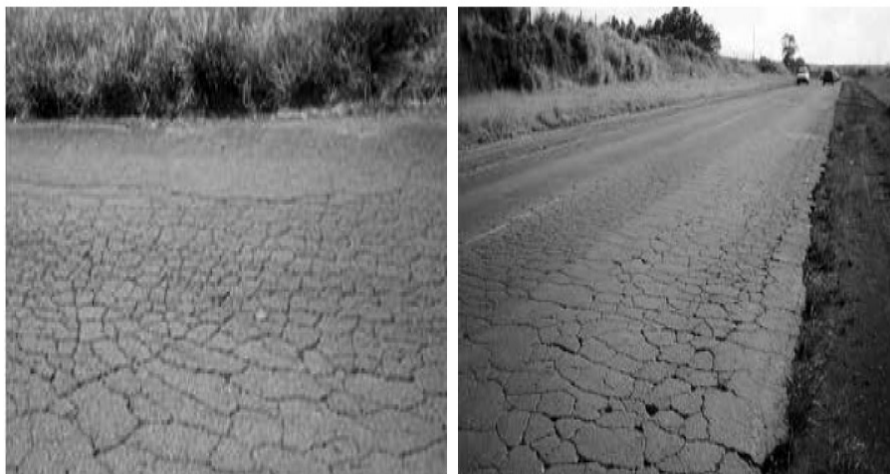
Figura 11 – Trincos devido a infiltração
