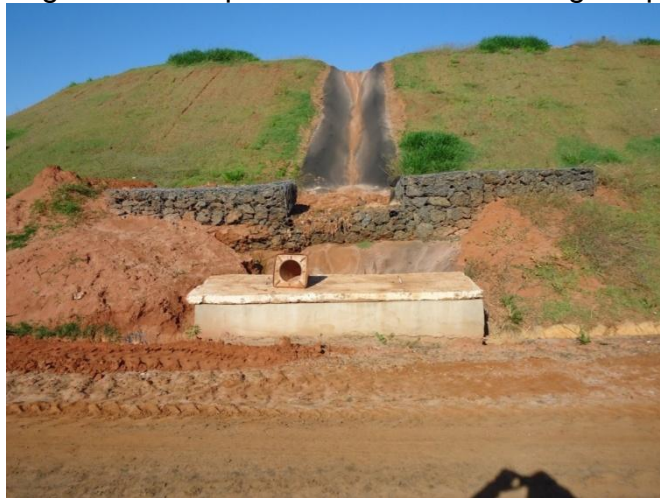
Figura 30 - Dispositivo de descida de águas pluviais.
