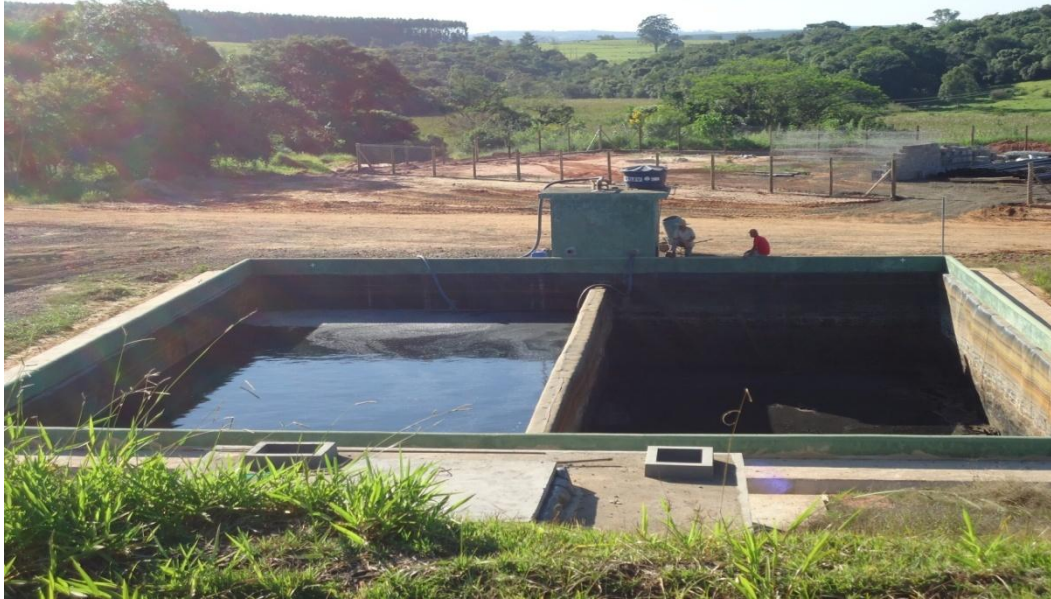
Figura 27 - Tanques de armazenamento de líquidos percolados (Chorume).
