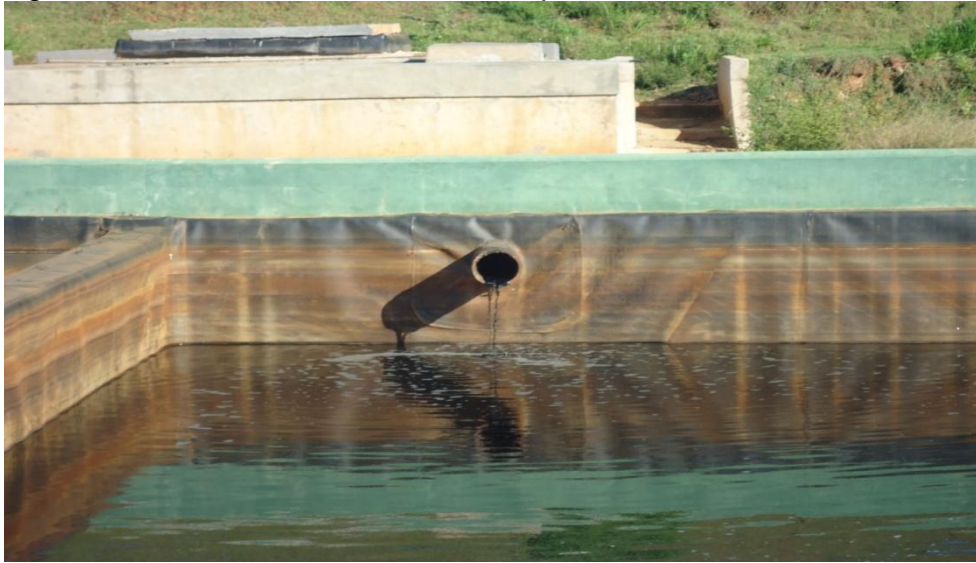
Figura 28 - Vazão de chorume no tanque de armazenamento.
