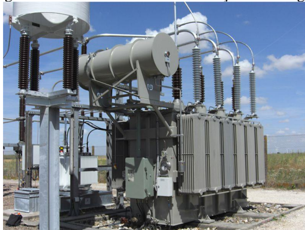
Figura 2. Transformador de Subestação de Energia.
