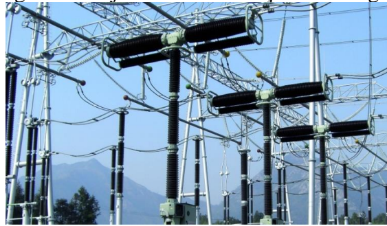
Figura 4. Disjuntor de Subestação de Energia.
