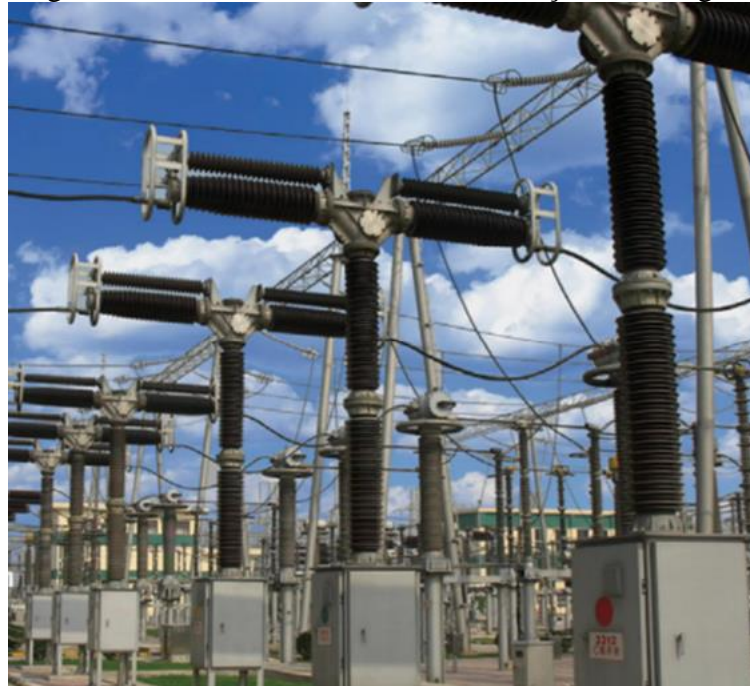
Figura 3. Chave seccionadora de Subestação de Energia.
