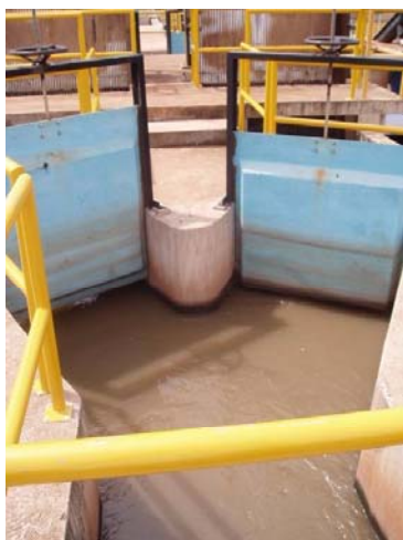
Figura 1 - Entrada do esgoto bruto
