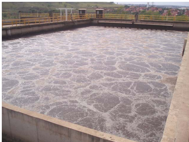
Figura 5 – Tanque de Aeração
