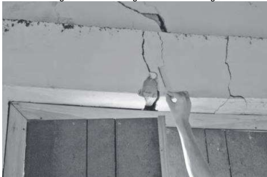
Figura 3 – Fissuras geradas em uma viga
