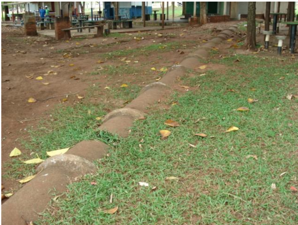
Figura 25 - Tubulação de esgoto Fonte: Arquivo pessoal
