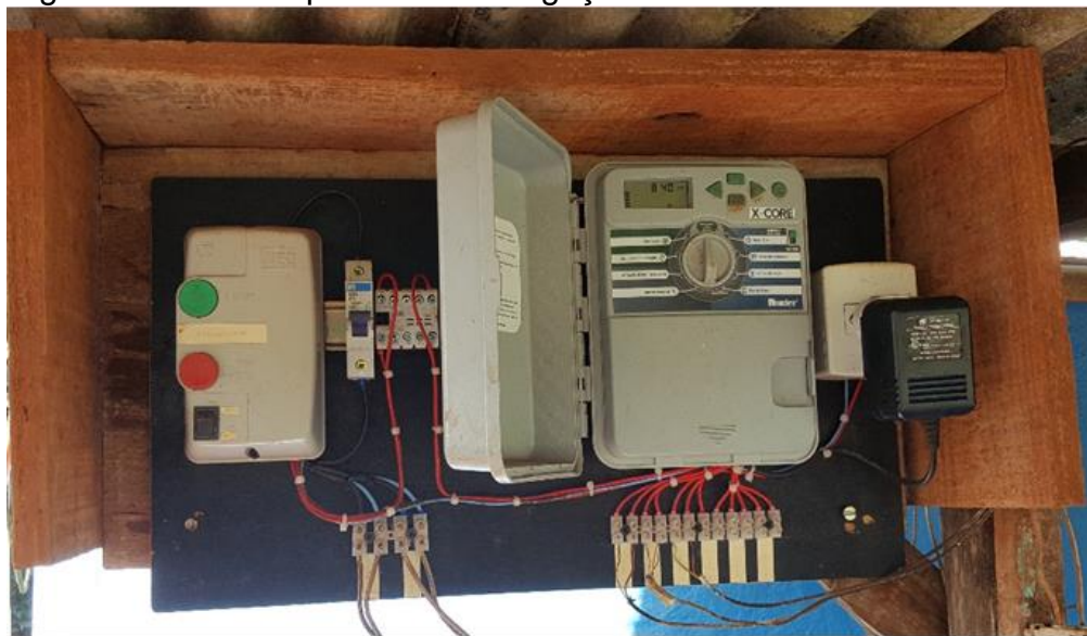
Figura 13 – Timer que aciona a irrigação
