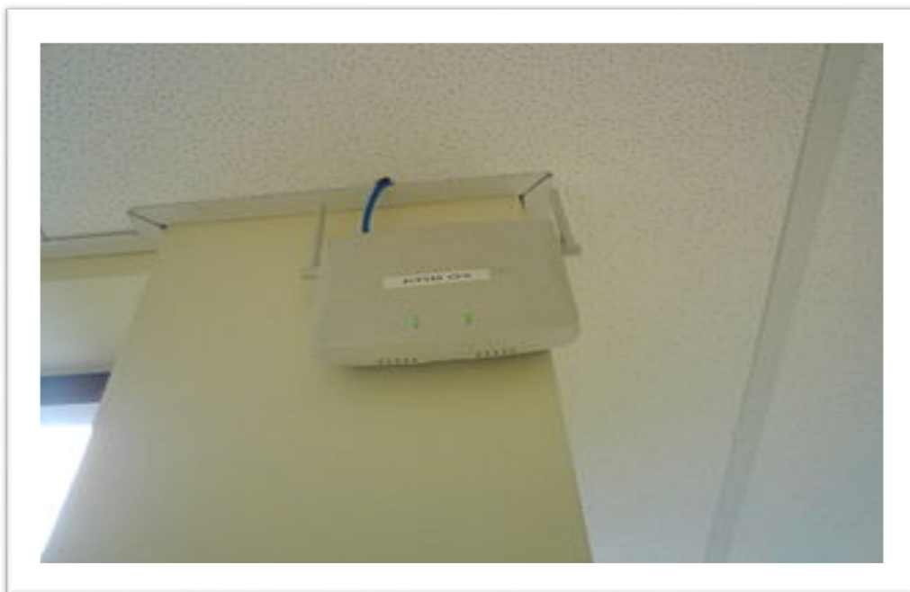
Figura 10 - Ponto de acesso.
