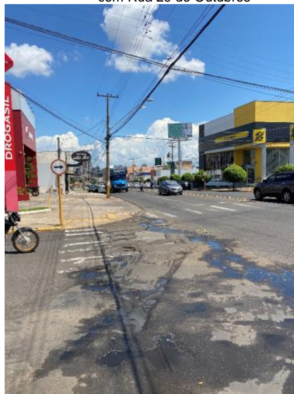
Figura 3.17: Irregularidades e ausência da faixa de pedestres no cruzamento com Rua 29 de Outubros
