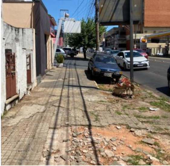
Figura 3.12: Calçada com buracos, próximo ao cruzamento com Rua Araújo Leite
