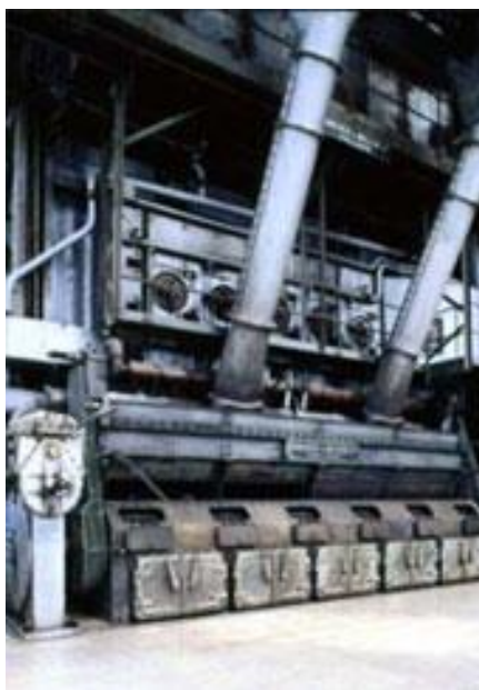
Figura 3 - Central Tejo - Caldeira de alta pressão de Babcock & Wilcox
